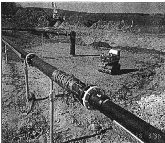
fig. 1 : Travaux de dégazage de l'ancienne décharge. Installation d'un puits + raccordement au collecteur Biogaz (photo. C. Léonard)
