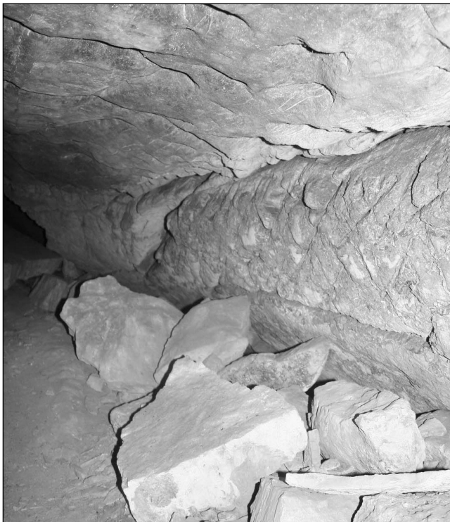
Paroi droite de la galerie à la base de laquelle s'accumulent des blocs (éboulis) décrochés de la voûte de la cavité
