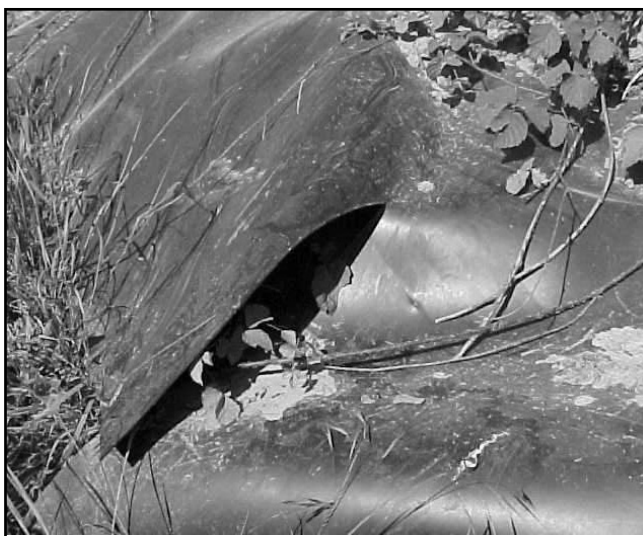
Les bâches actuellement posées dans la carrière ne semblent pas offrir toutes les garanties en terme de perméabilité. Par ailleurs il faudrait être sûr qu'il n'y a plus de déchets en-dessous!
