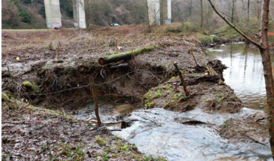
Fig. 13. En 2017, la perte P3 s’est rouverte, avec l’effondrement de la berge. Elle devient la perte la plus importante du secteur, alors qu’elle est située à 40 mètres des piles du viaduc.
