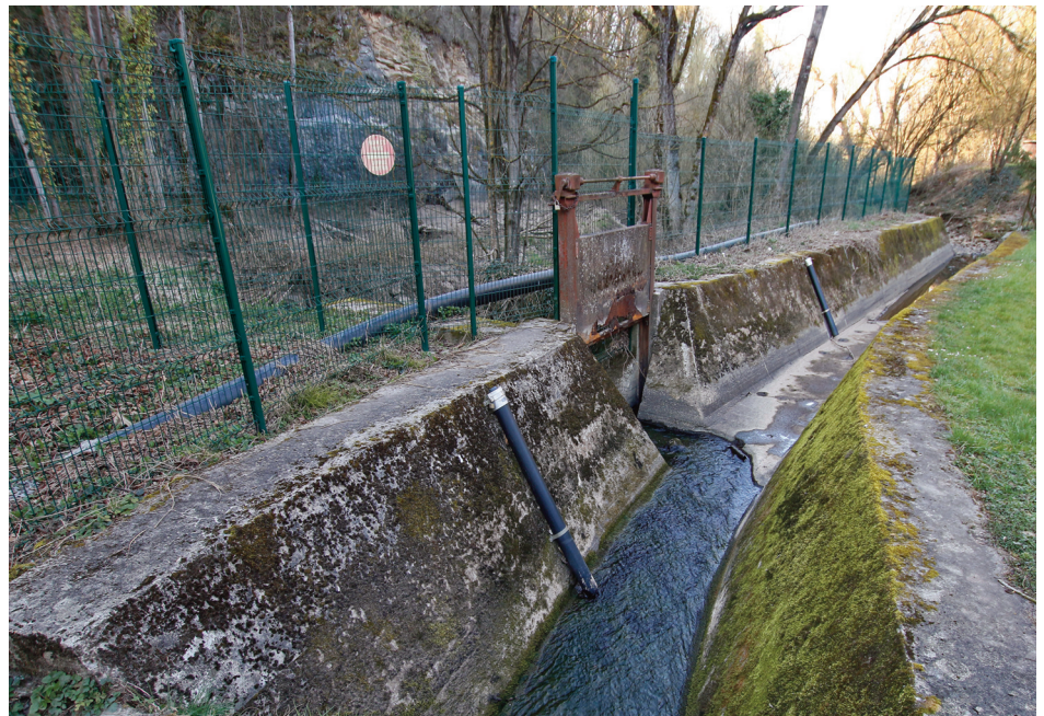
Fig. 4. La canalisation du ruisseau au droit du chantoir Mathot est équipée d'une vanne. En mars 2025, toutes les eaux de surface sont dirigées vers la dépression absorbante du chantoir.
