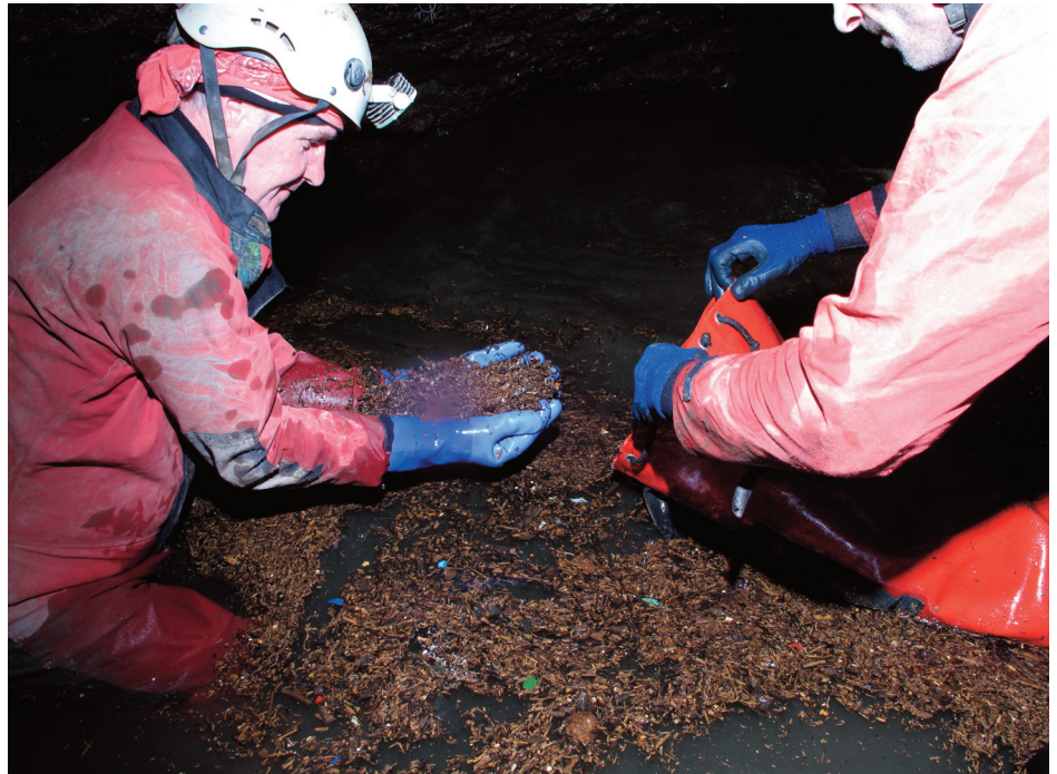
Fig. 2. En surface du siphon, dégagement, des éléments qui entravent son accès (photo G. De Sadelaer).
