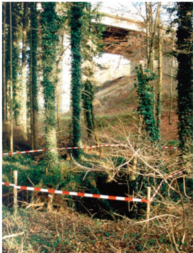
Fig 9. En décembre 1999, un effondrement (P3) s'est ouvert rapidement en rive gauche. On estime que plus de 50 m 3 de terre et de matériaux meubles y ont été soutirés.
